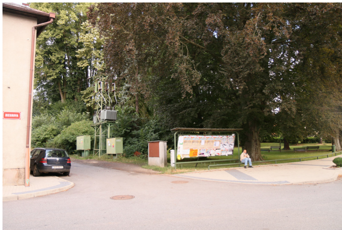
Pohled na plakátovací plochu a rozvodné skříně sítí tech. infrastruktury.
